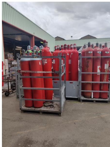
Figure 69. Entreposage de l'argonite, du CO2 et du Proinert-IG55
