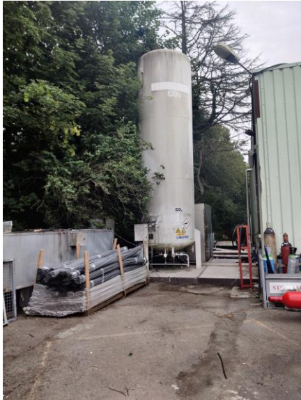
Figure 16. Cuve extérieure de CO 2
