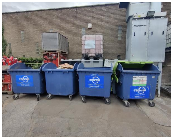
Figure 79. Containers destinés aux déchets classique (résiduels, PMC, papier/carton) ainsi que le cyclone de récupération des poudres
